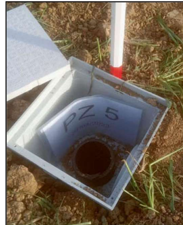
particolare di un pozzetto di un piezometro
